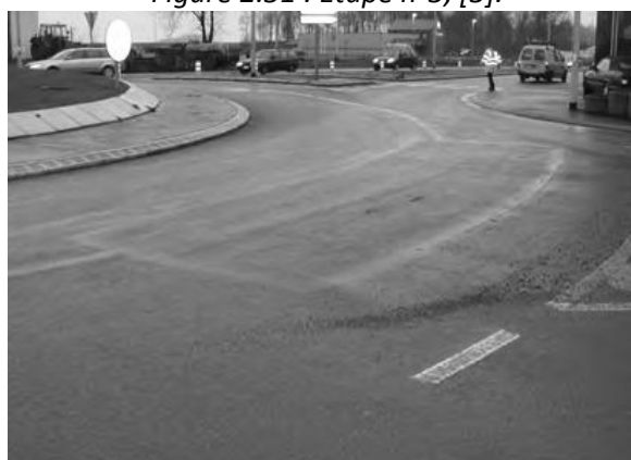
Figure 2.33 : un an après la réparation, [3].
